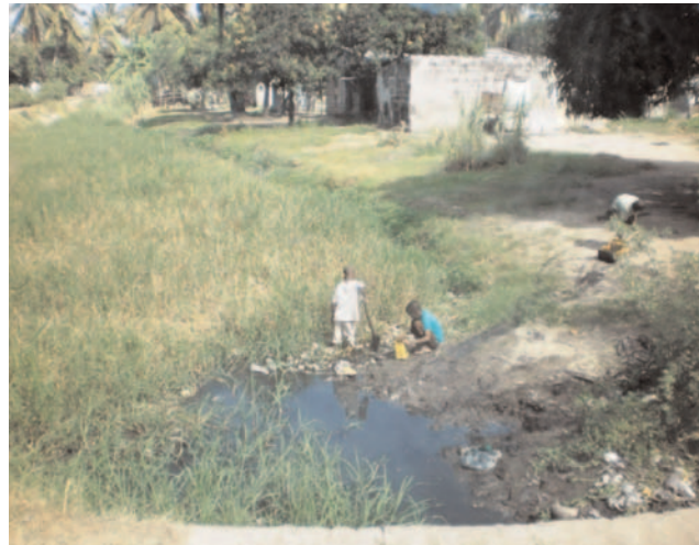
Fig. 8. Estado actual de los canales de desagüe de la ciudad de Beira/Current state of the drainage channels in Beira.
